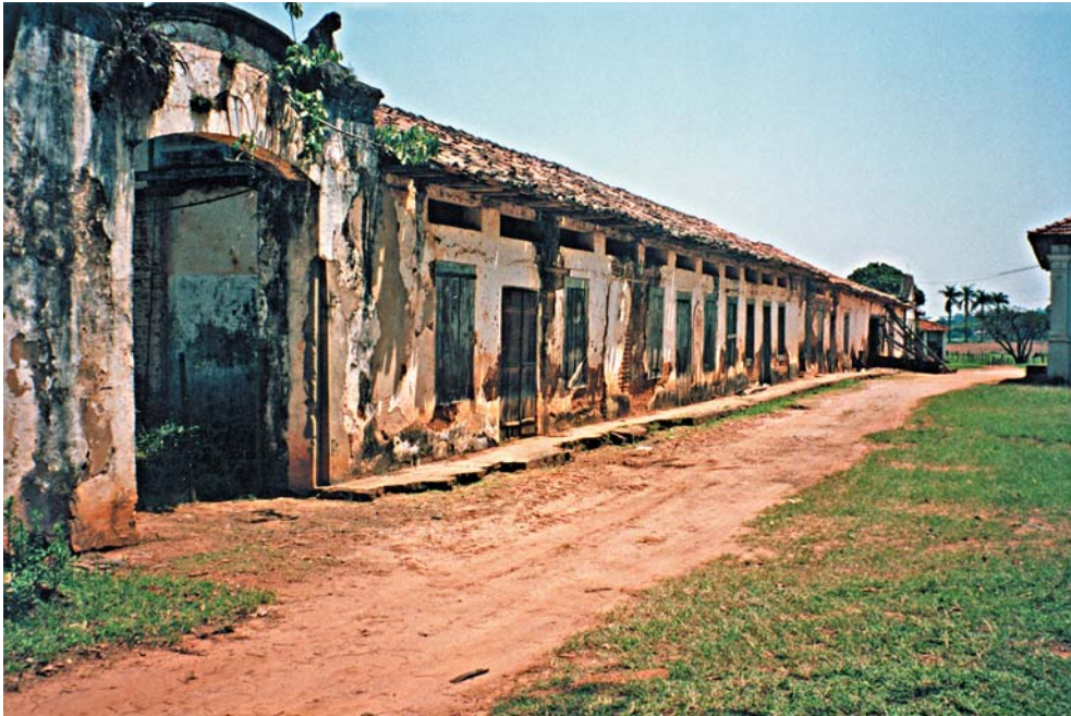
Figura 29 – Fazenda Pau d’Alho. Senzala da fazenda de café erguida na segunda metade do século XIX. Segmento da parede do curro onde ficava a porta de entrada. Erguida em taipa de pilão com divisórias em taipa de mão. Fotografias da equipe.
